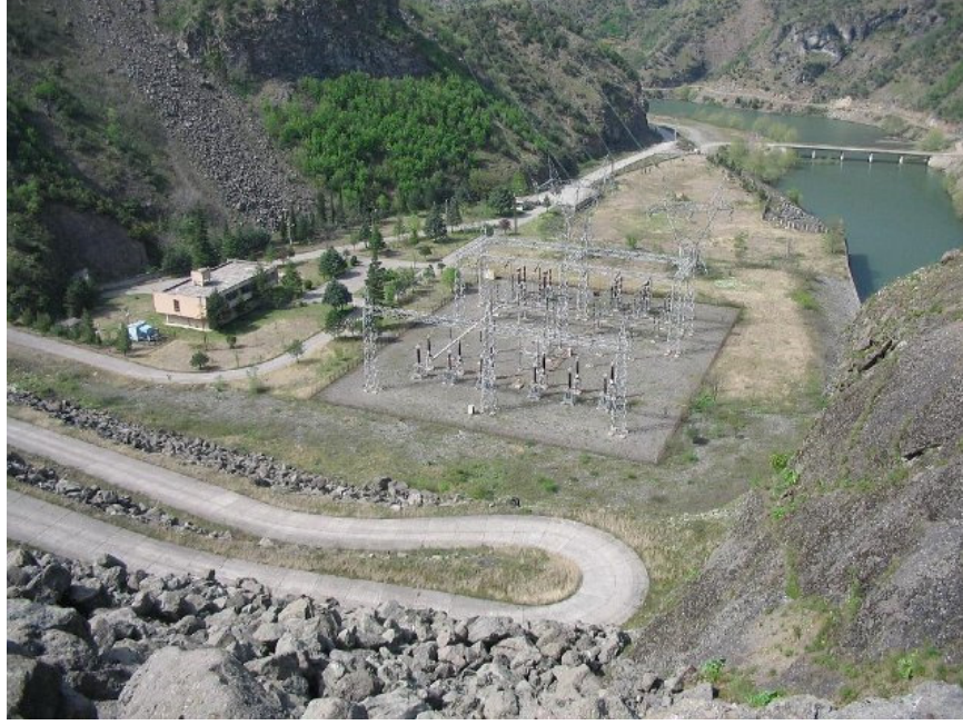
Hasan Uğurlu Şalt Sahası
